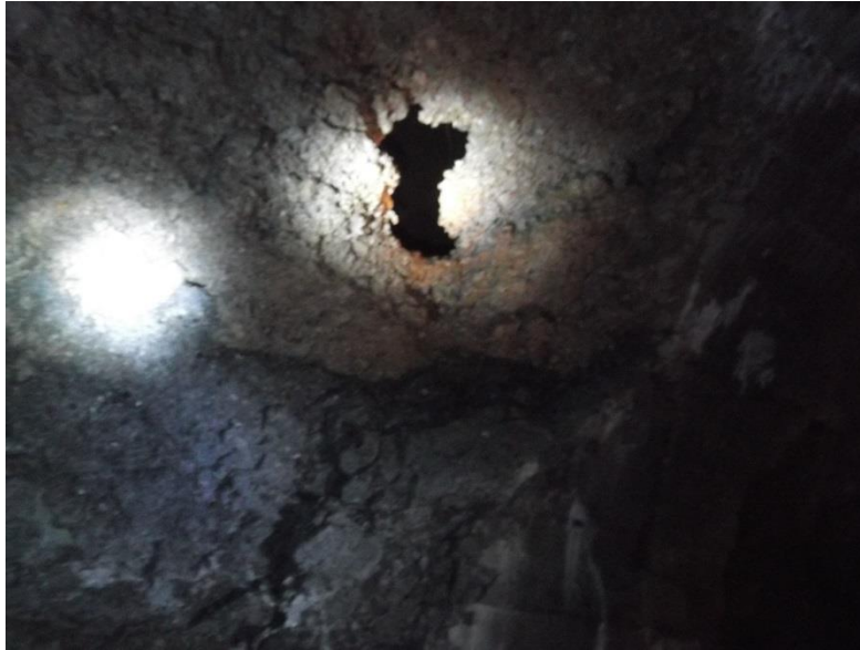
Esteso vespaio e distacco del cls con presenza di cavità all'estradosso (paramento di monte e volta)
