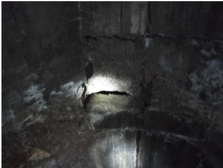
Distacco di rivestimento dalla volta in corrispondenza di una ripresa di getto. Al di sopra del rivestimento si apre una cavità.
